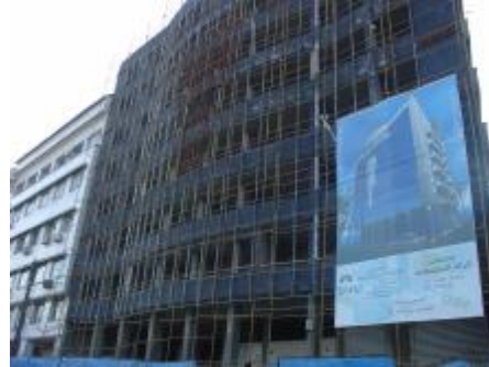
المبنى قبل الإكساء ونلاحظ كيف أن المعماري لم يراع الناحية الوظيفية للمبنى حيث أنه استخدم الزجاج بمساحات كبيرة مشفى - حمص -
